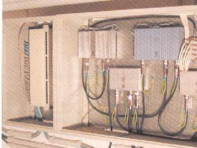
Bild 4. Netzverteilerschrank in Duisburg
