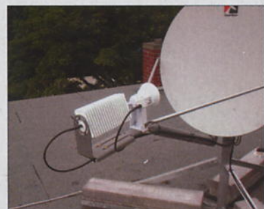
Zwei Kabel - eines zum Empfangen, eines zum Senden - gehen vom LNB zum Satellitenmodem
